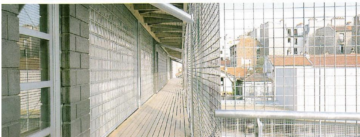
Detalhe das passarelas externas na fachada sul, conduzindo a uma escada externa de ligação com o pátio
